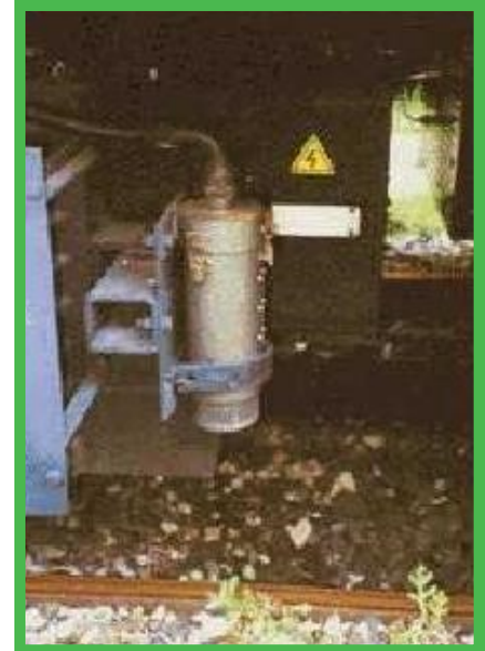
702 Respiradero del transformador
